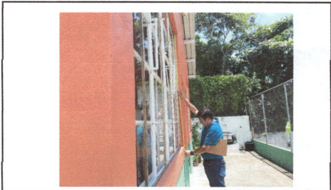
Foto 4: Vista de balcones que necesitan reforzar
