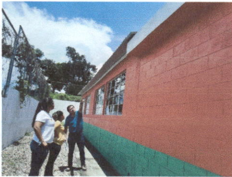
Foto 7: Vista problema de filtraciones en terraza
