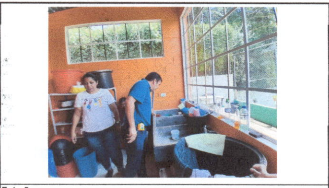
Foto 5: Vista de pila que esta en mal estado
